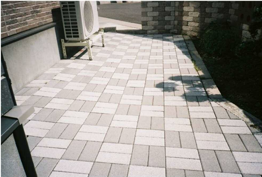
玄関に発生したくぼみ
