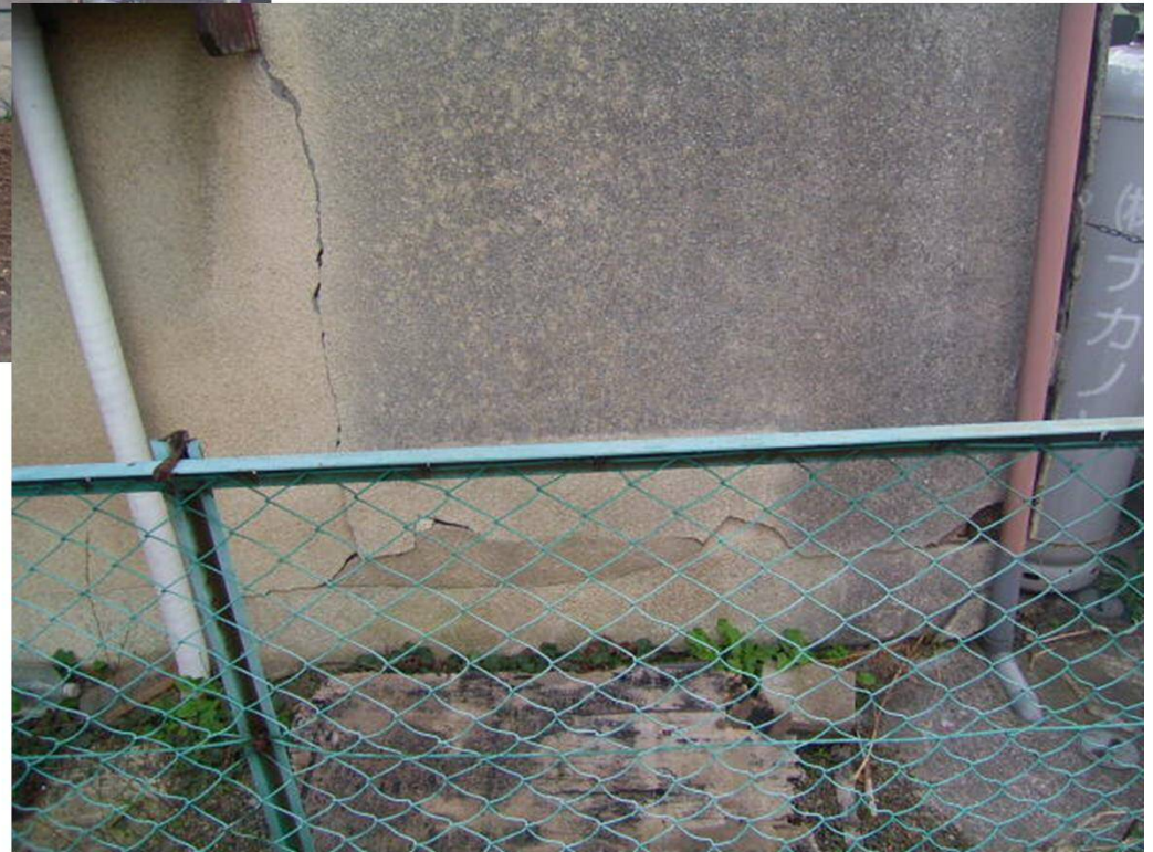
建物の割れ目
