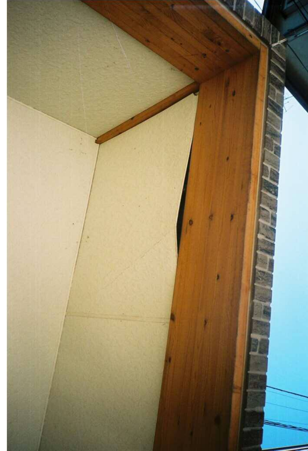
壁にも割れ目が...
