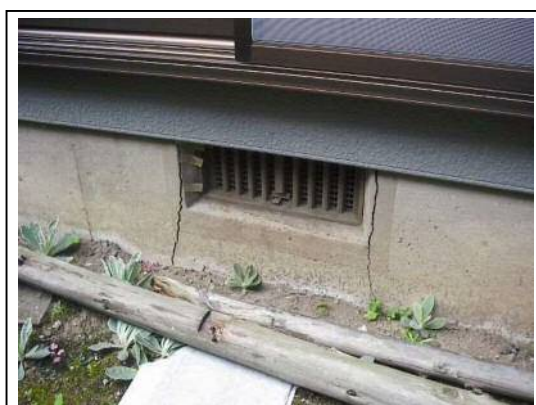
図 1-2-28 建物基礎の異常
