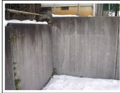
図 1-2-36 擁壁異常の例
