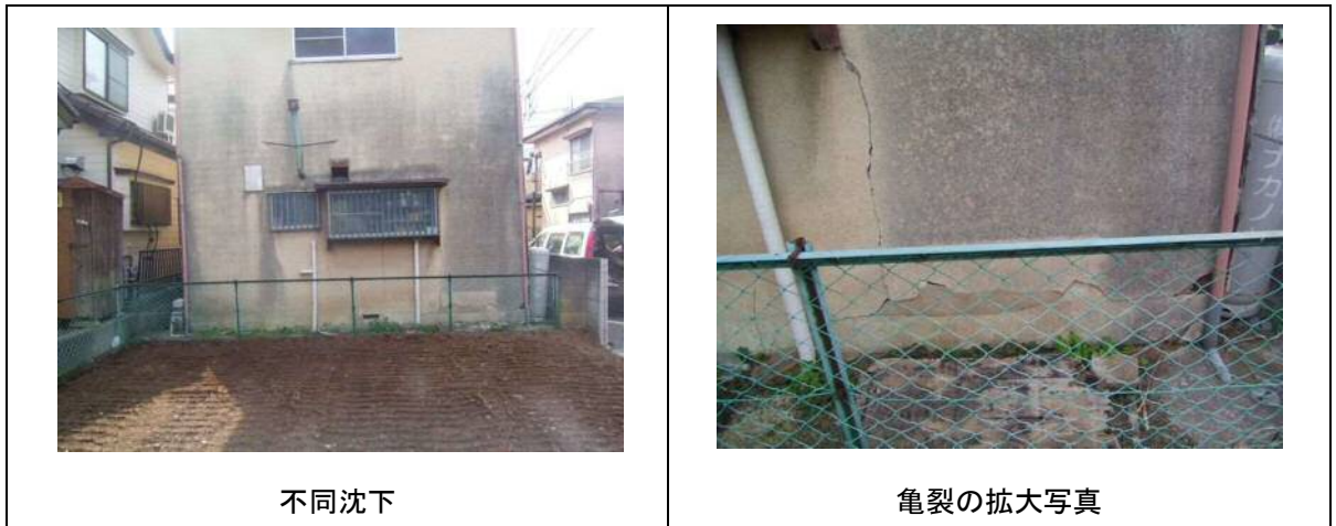
図 1-2-29 外壁の亀裂写真例
