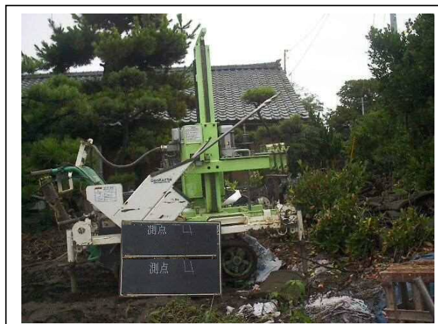
図 1-2-1 調査装置設置不良の例
